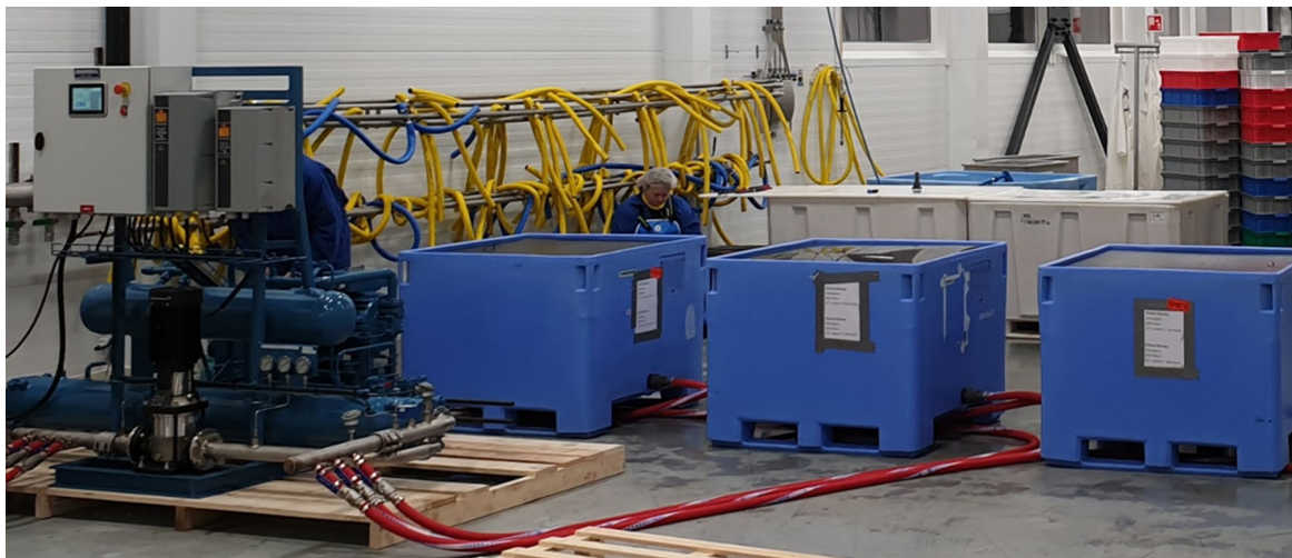
Bilde 1 Lakefryserunit med 3 innfrysingskar som mettet, kjølt saltlake sirkulerer mellom.
